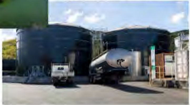
Photo 2 : Unité de traitement des lixiviats
